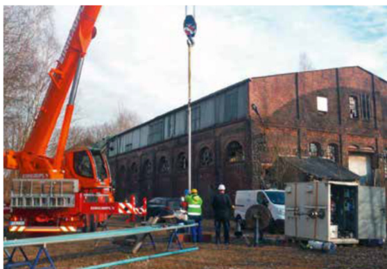
Abb. 3: Einbau der Probenahmetechnik an der Messstelle Gersdorf-Kaisergrube.
